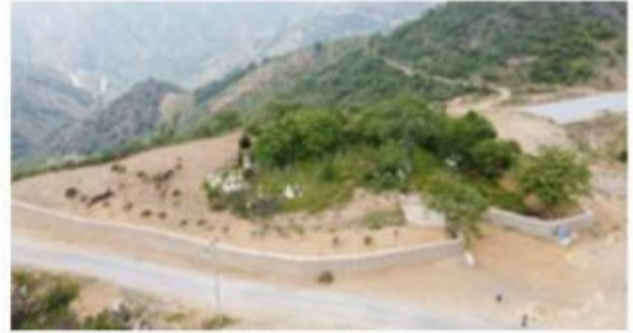
Karahallı Merkez Yol Kenarı İstinat Duvanı
